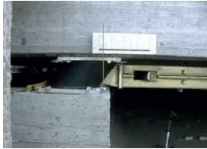
Isolatore in elastomero armato: isolatore deformato (deformazione di 170 mm) durante l'esecuzione di prove di rilascio in sito (fonte: TIS s.p.a., Roma).
